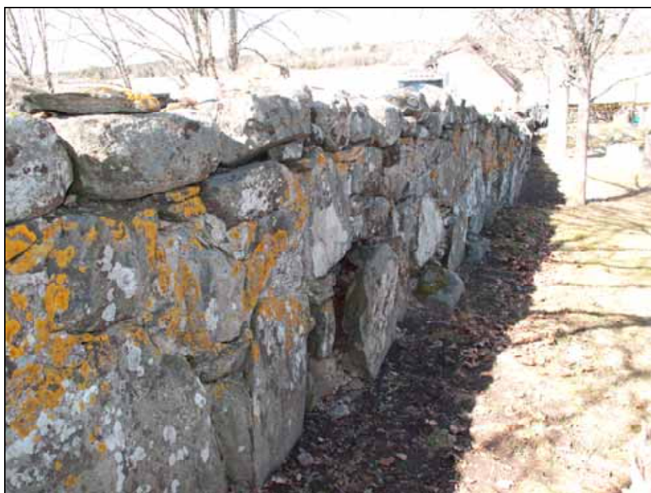
Punkt 9. Utskjutande mur före reparation. Foto: Lisa Sundström, bildnr: lp20100362.
